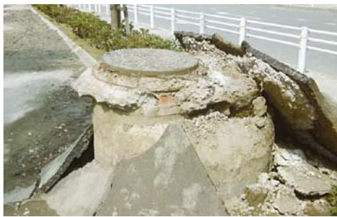
東日本大震災での浦安市内の被害
